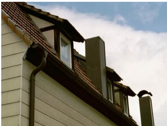
negativ: hohe, verkleidete Kamine und Abdeckhaube
