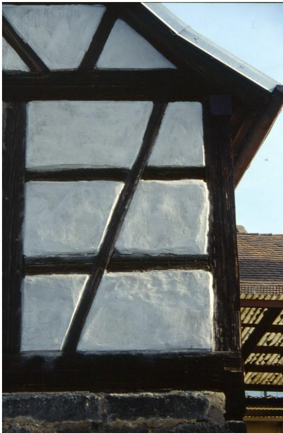
schöner kissenförmiger Verputz, aber Fachwerkbalken zu dunkel
