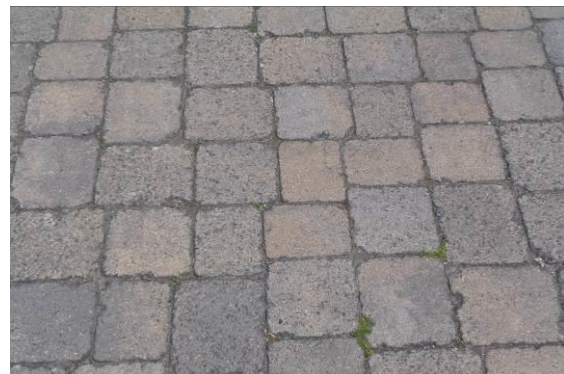
Betonsteinpflaster mit Natursteinvorsatz, unregelmäßige Verlegung, die Fugen könnten etwas breiter sein
