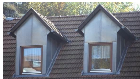
Fenster zu niedrig oder Gaube zu hoch, Fenster und Verkleidung nicht gut
