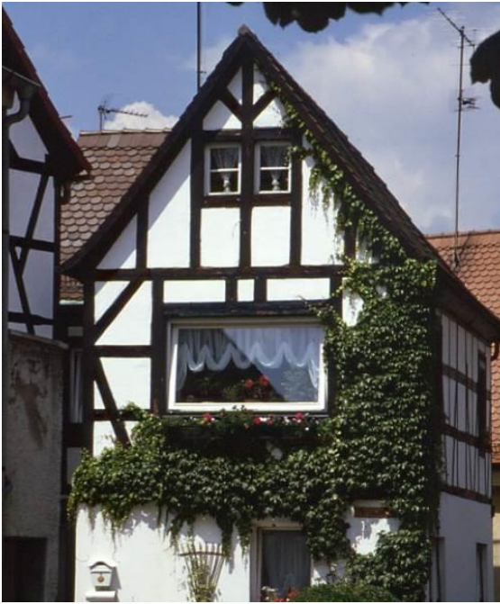
durch Fenster zerstörtes Fachwerk
