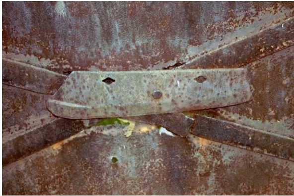
Detail, von Rost befallen
